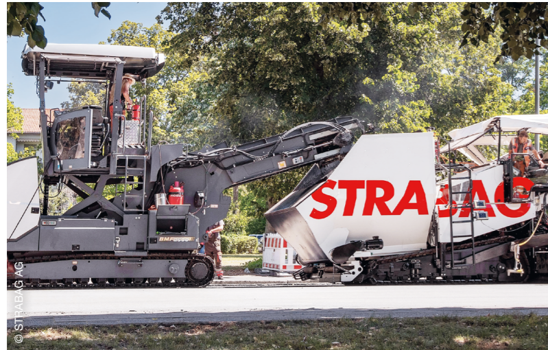
© STRABAG AG CIAir® Asphalt-Einbau mit dem Innovationsfertiger der STRABAG AG in Erlangen
